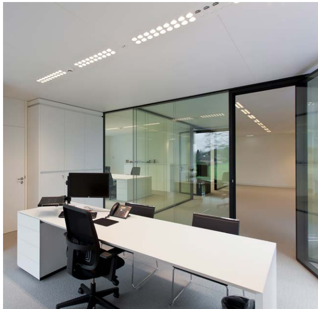
Med integrerade brandvarnare, ventilation och nödbelysning.
